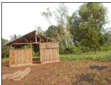
Photo 2 : Construction en cours d'une Eglise à côté d'une forêt sacrée "Egoun-zoun" dans l'Arrondissement I
